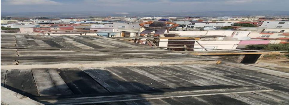
Şekil 5. Bina döşeme katının mevcut durumu ile ilgili resim
