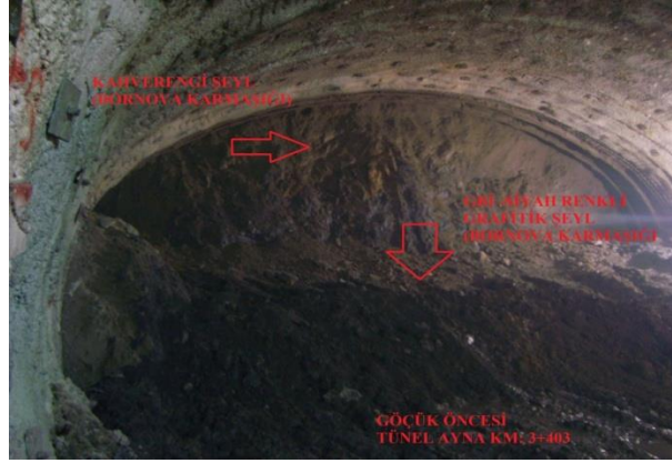
Şekil 4. Göçük öncesi km:3+403 tünel aynası durumu
